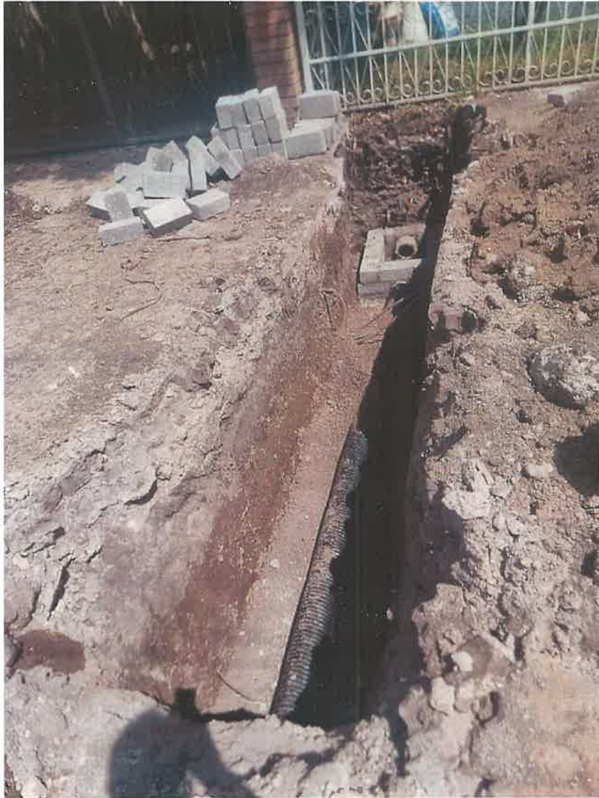
Instalación de Descarga Sanitaria.
