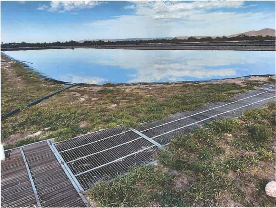
Laguna de Maduración en PTAR.
