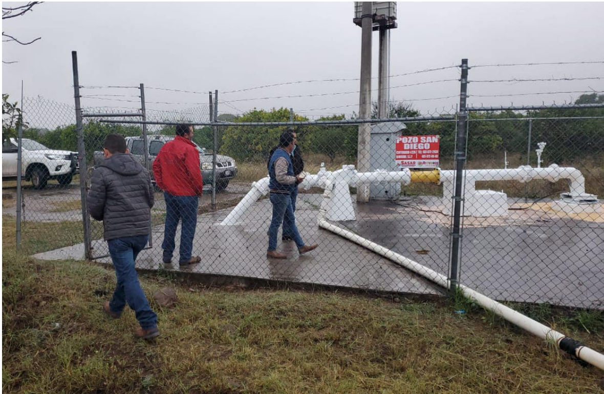
Pozo San Diego.
