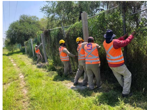
Reparaciones puntuales en cercado perimetral dañados por efectos de derrumbe de árboles en temporada de lluvias.
