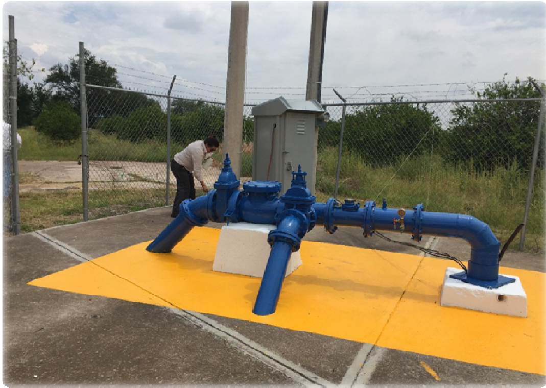
Pozo San Diego.
